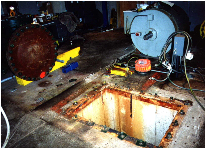
No. 2: L'espace disponible pour la turbine nouvelle à impulsion radiale est bien limitée. En gauche la bride d'entrée d'eau, l'ouverture de fond pour la sortie de turbine et l'arbre de la génératrice en arrière. Il fallait placer la turbine et la multiplicatrice entre eux.
