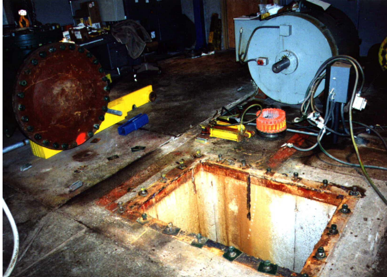
Abb. 2: Der Platz für die neue Durchströmturbine ist beschränkt. Links der Wassereinlaufflansch, die Bodenöffnung für den Turbinenauslauf und die Generatorwelle im Hintergrund. Turbine und Getriebe mußten dazwischen passen.
